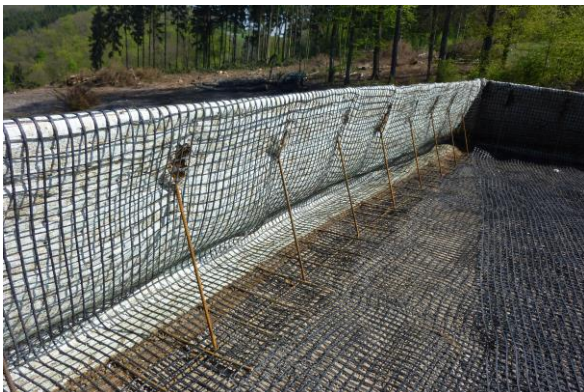
Abspannhaken der Stahlgitterwinkel
