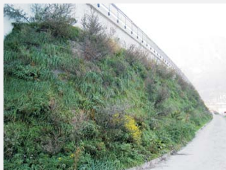
Zustand der begrüneten Böschung - wenige Wochen nach Baufertigstellung!
