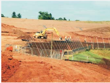
Auf Grund der guten Wasserleitfähigkeit von Rock PEC konnte das anstehende kohäsive Schüttmaterial verwendet werden.
